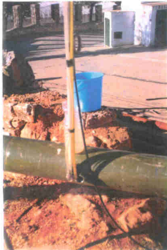
Detalle de dispositivo de medida de caudal en tubo de Pitot
