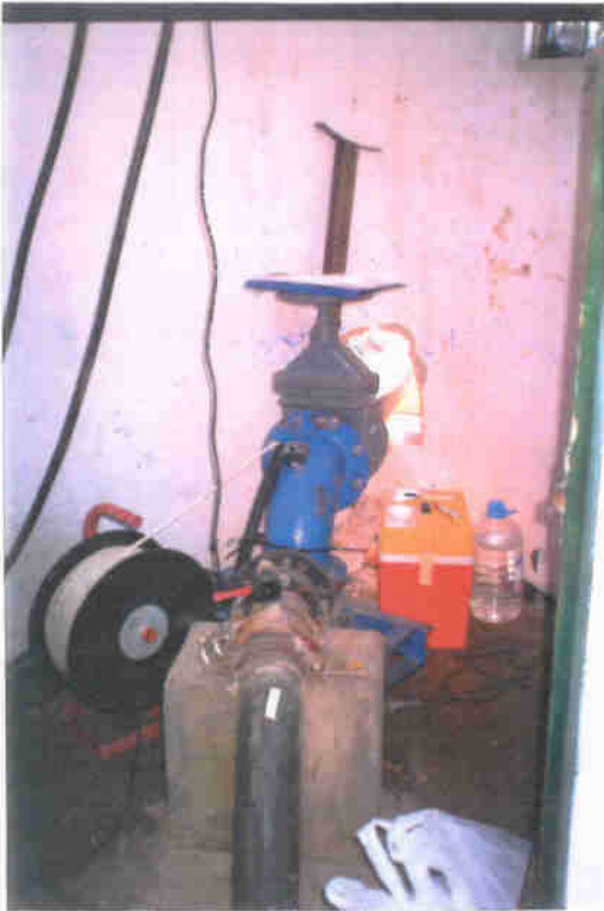
Detalle de la instalación de tubo de Pitot
